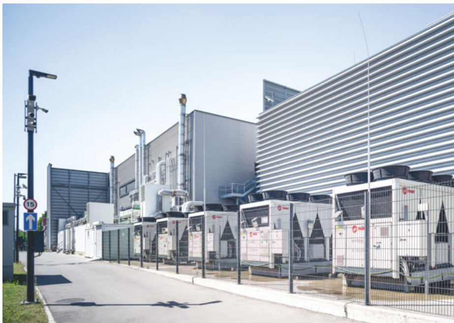
Fünf Wasserkühlmaschinen halten die Temperaturen im Equinix Rechenzentrum ZH5 auf unter 27 Grad Celsius.
