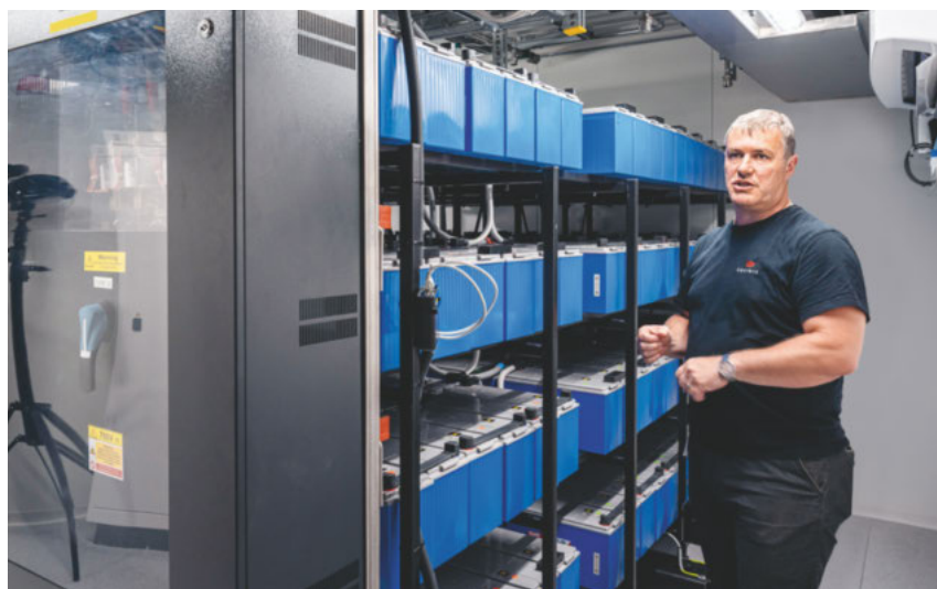
Bei einem Stromausfall läuft der Betrieb während 32 Stunden unter Vollast nahtlos weiter. Roger Beeler im Batterieraum der Notstromversorgung.
